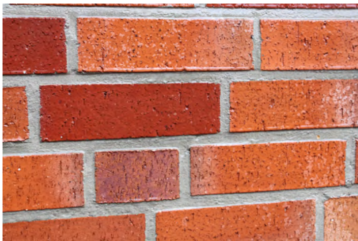
Abb.1 Unbehandelte Fassade. Wasser wird vom Baustoff aufgenommen.
